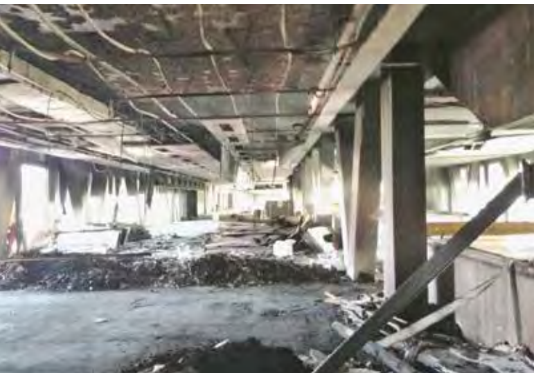
Campus Brugg-Windisch nach dem Brand
